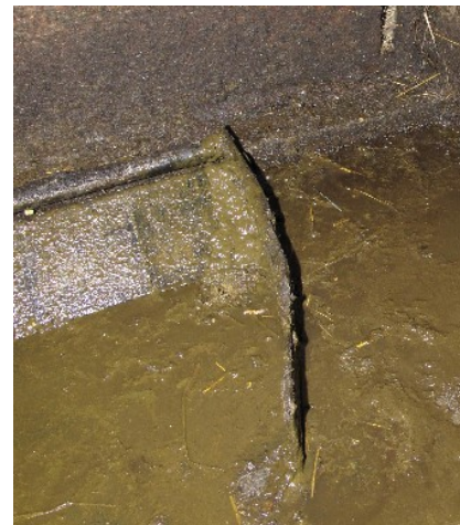
Bild 2) Scharfe Kanten stellen ein erhöhtes Verletzungsrisiko dar
