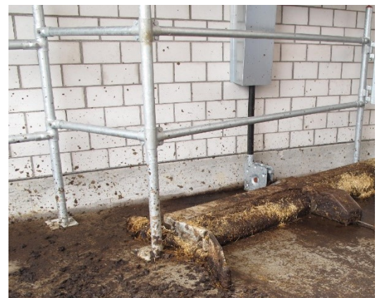
Bild 6) Abschränkung sichert Schieberbahnhof und Umlenkrolle
